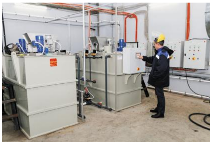
Цех по обезвоживанию осадка сточных вод на очистных сооружениях канализации г. Горно-Алтайска
