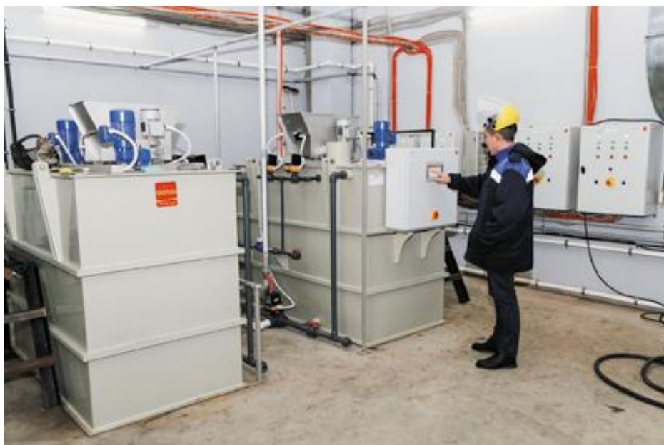
Цех по обезвреживанию осадка сточных вод на очистных сооружениях канализации г. Горно-Алтайска
